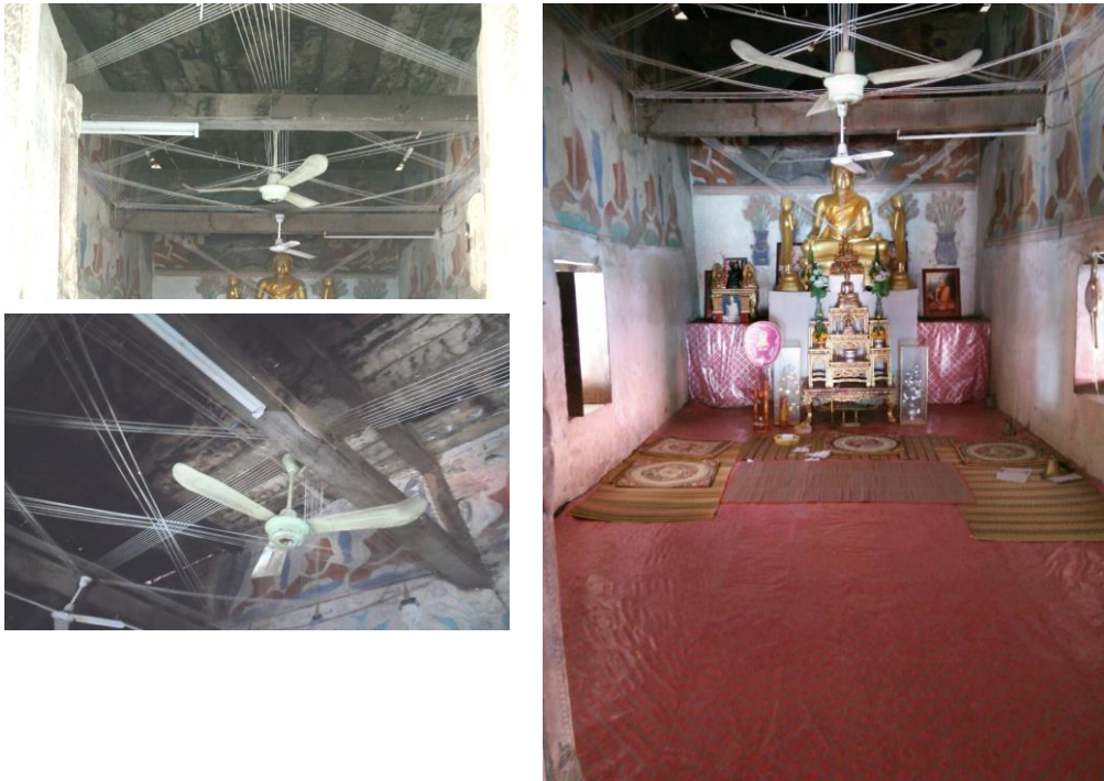
ภาพที่ 2.5 ผนัง พื้น ฝ้าเพดานภายในอุโบสถ และโครงสร้างหลังคาอุโบสถวัดท่าเรือ
