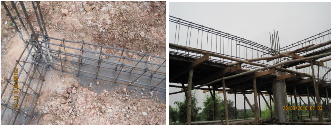
ภาพที่ 5.11 เหล็กเสริมคานคอดิน และเหล็กเสริมคานชั้นที่สอง
