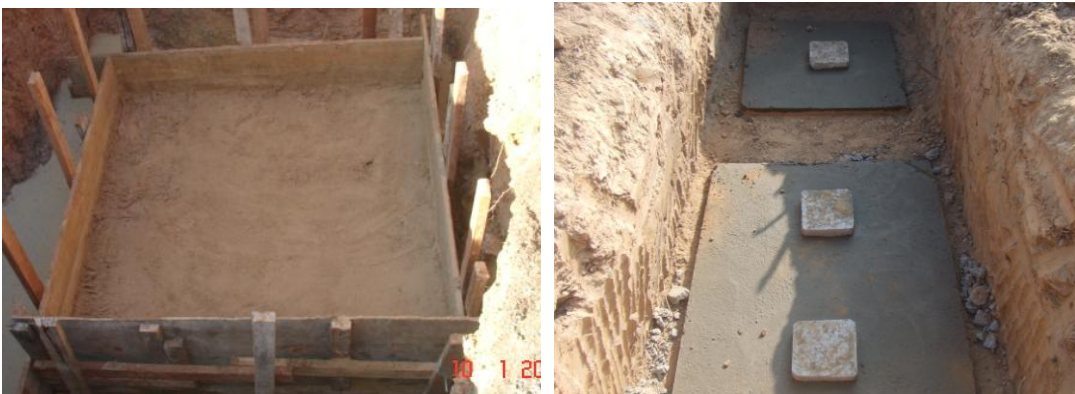
ภาพที่ 4.1 ทราฮายาบ และคอนกรีตหยาบเป็นวัสดุรองพื้นสำหรับก่อสร้างฐานราก
