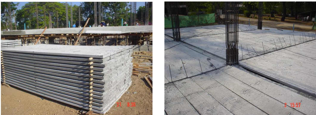
ภาพที่ 4.9 แผ่นพื้นสำเร็จรูปและการเสริมเหล็กที่รอยต่อของแผ่นพื้นสำเร็จรูปตามแนวคาน
