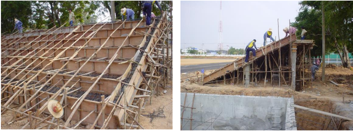
ภาพที่ 3.6 ไม้แบบหล่อ ไม้คร่าวสำหรับยึดแบบและไม้ค้ำยันแบบหล่ออัฒจันทร์
