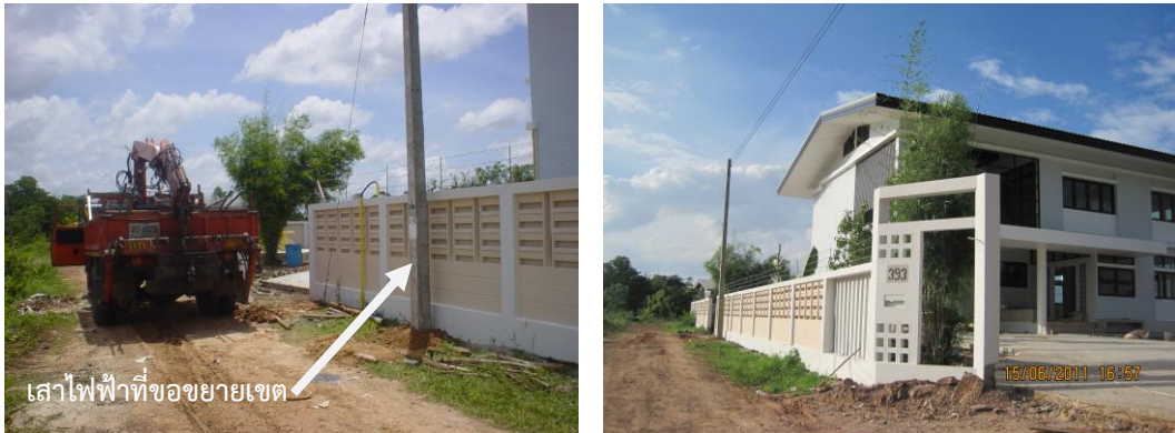
ภาพที่ 12.3 การปักเสาไฟฟ้าเดินสายไฟแรงสูงขยายเขตการใช้ไฟฟ้าและติดตั้งมาตรวัดไฟฟ้า
